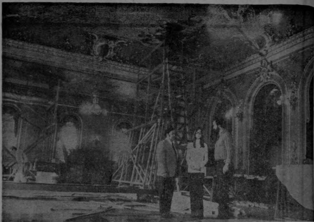
En esta gráfica se puede apreciar el avance en los trabajos de remodelación y reparación que han estado haciendo técnicos europeos traídos especialmente.
